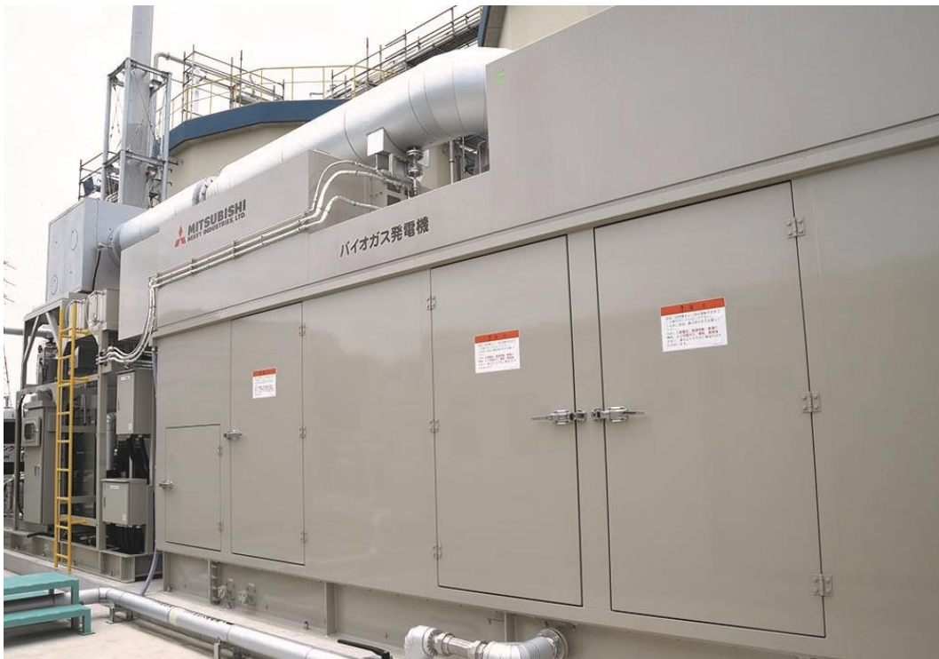
バイオガス発電施設 バイオガス発電機
